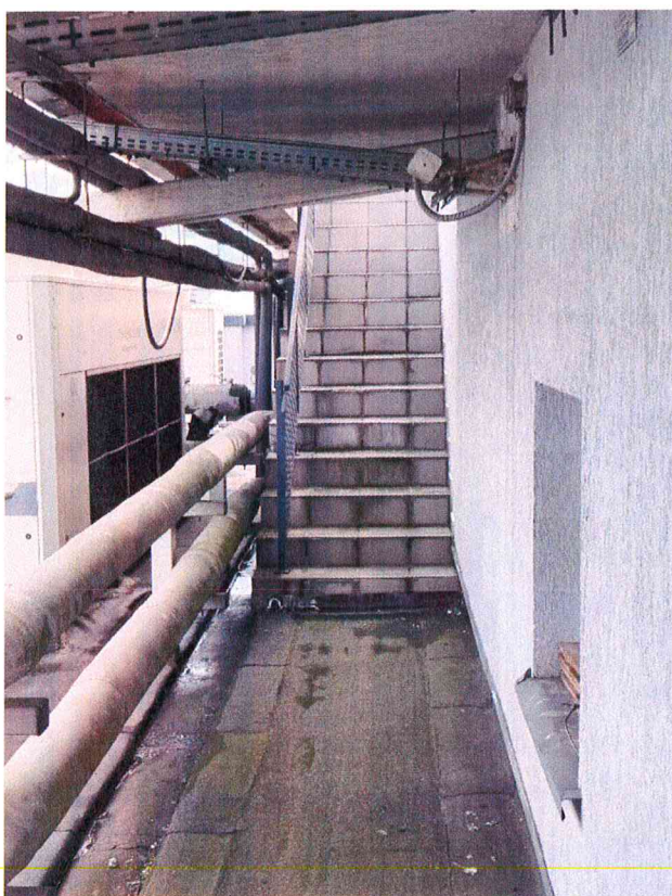
Fot. 12. Elementy instalacyjne w przestrzeni dachu, schody z poziomu dolnego dachu na górny.
