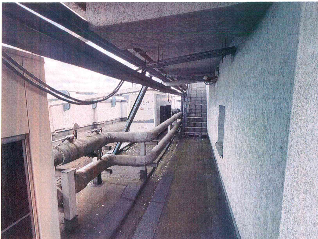
Fot. 11. Elementy instalacyjne w przestrzeni dachu, schody z poziomu dolnego dachu na górny.
