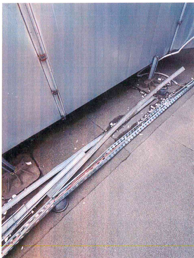
Fot. 10. Elementy instalacyjne w przestrzeni dachu.
