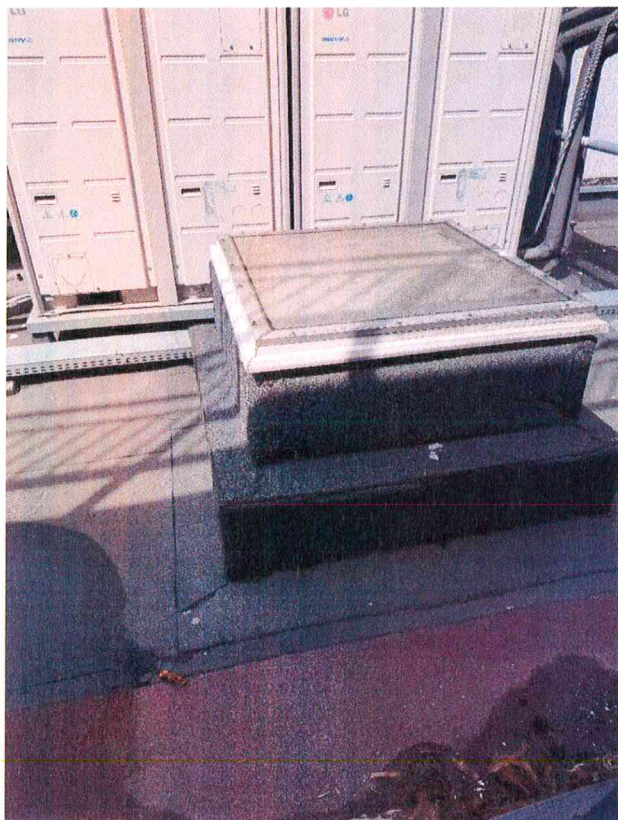
Fot. 16. Świetlik dachowy wymagający poprawy wykonanych obróbek.
