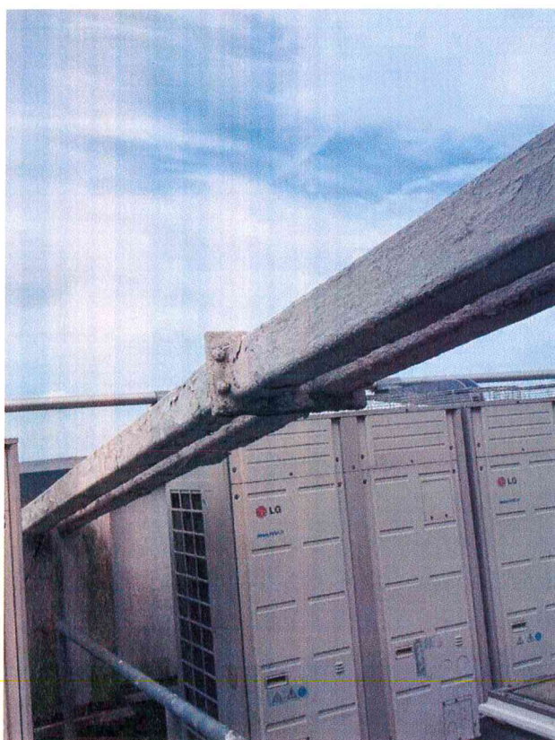
Fot. 14. Urządzenia HVAC na dachu oraz elementy stalowe, wymagające oczyszczenia.
