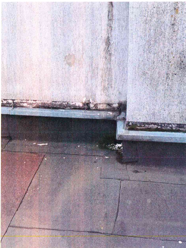
Fot. 8. Uszkodzenia obróbek blacharskich i ściany ponad nimi, zbyt mały promień gięcia papy wychodzącej na ścianę.
