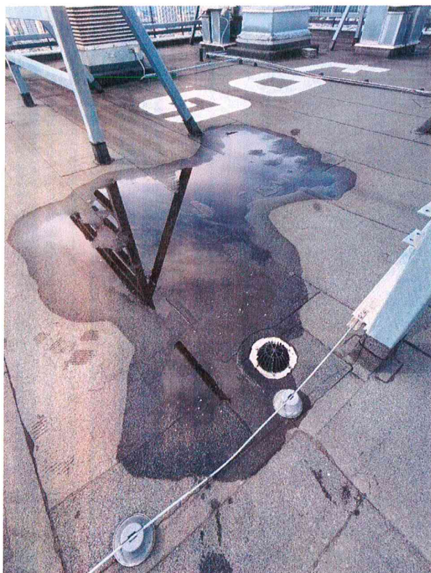
Fot. 15. Górny poziom dachu, widoczne urządzenia oraz zastoiska wody opadowej w rejonie odpływu.
