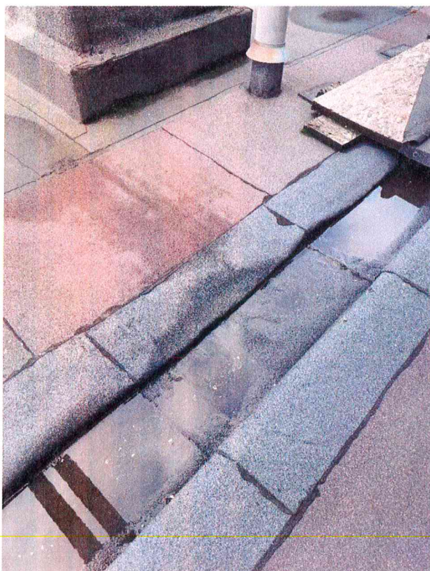
Fot. 4. Widok dolnego poziomu dachu. Widoczne uszkodzenia pokrycia i zastoiska wody w korycie odwadniającym. Niewłaściwie obróbki elementów ponad dachem, ze zbyt małym promieniem gięcia papy.
