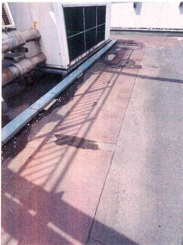
Fot. 17. Dolny poziom dachu, widoczne elementy instalacji HVAC oraz koryta kablowe.
