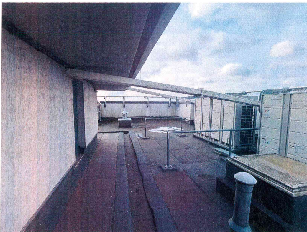
Fot. 3. Widok dolnego poziomu dachu wraz z urządzeniami. Widoczne uszkodzenia pokrycia przy korycie odwadniającym oraz elementy stalowe do oczyszczenia.
