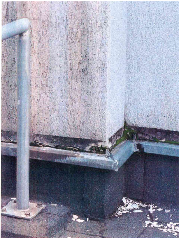
Fot. 7. Uszkodzenia obróbek blacharskich i ściany ponad nimi.
